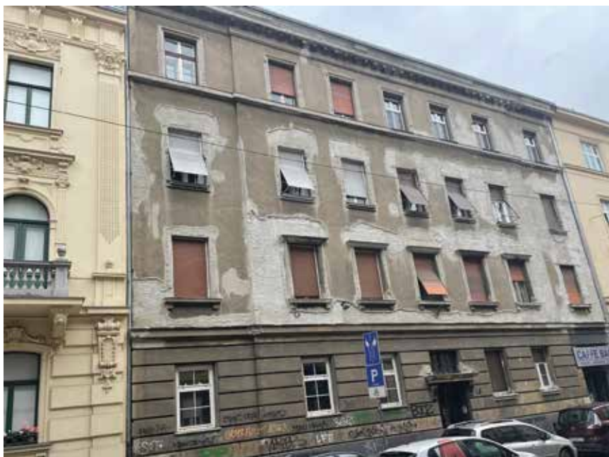
Postojeće stanje većine pročelja u hrvatskim gradovima
